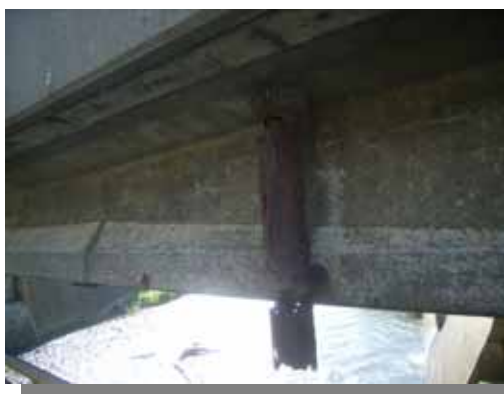
写真-3 排水管の損傷
