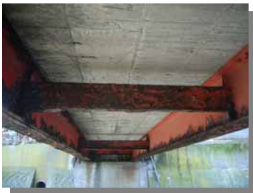
写真-1 鋼橋の劣化状況
