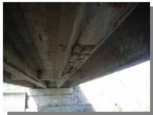
写真-2 コンクリート橋の劣化状況
