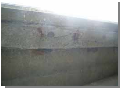
写真-5 地覆（水切り部）の損傷
