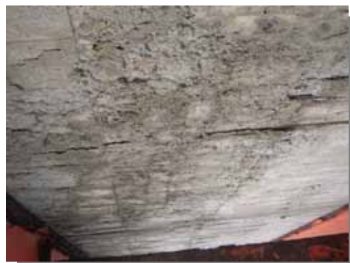
写真-5 床版の損傷
