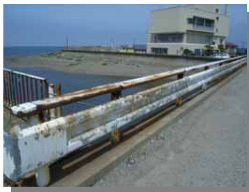
写真-4 ガードレールの劣化
